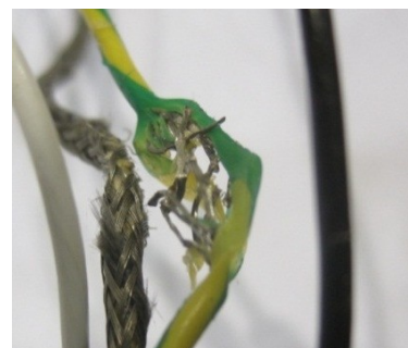
Рисунок 79: Поврежденный кабель заземления
