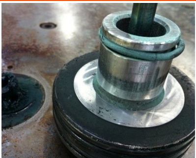
Рисунок 90: Повреждение уплотнителя поршня
